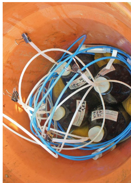
Schutzschacht mit Ansaugröhrchen und Sammelflaschen für Sickerwasser.
